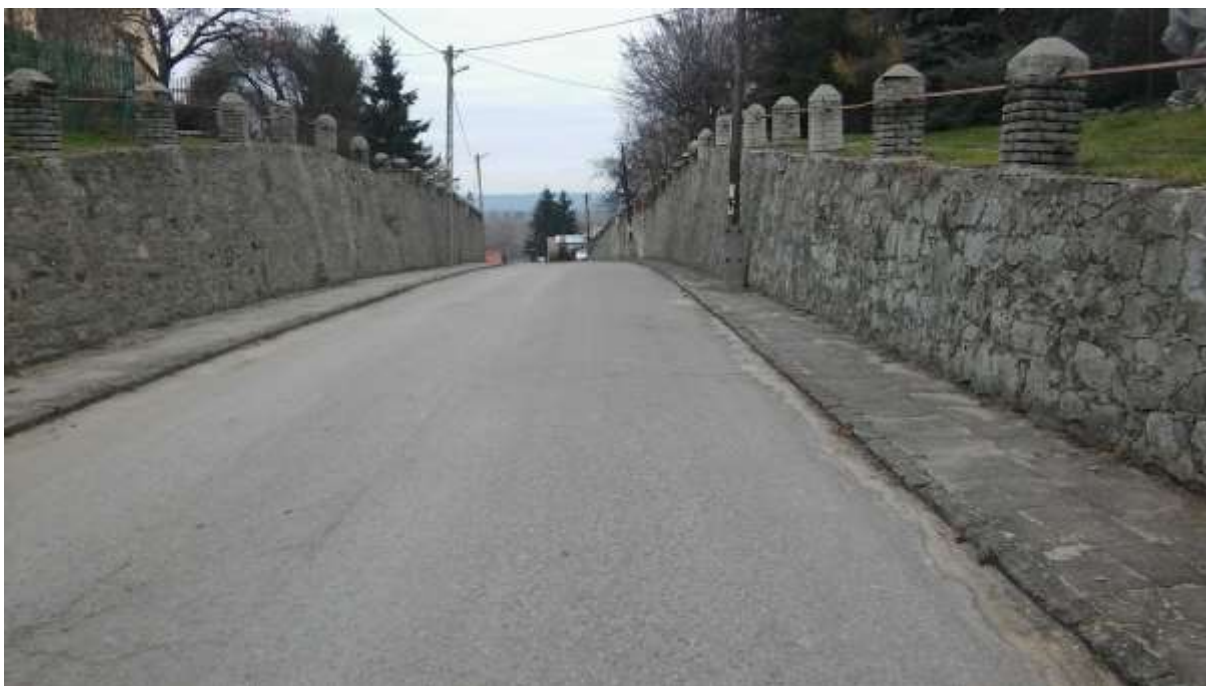
Zawichost, ul. Świętego Leonarda – potrzeba remontu nawierzchni drogi, chodników i zabezpieczeniem murów oporowych (fot. P. Pietruszka – FRESH-BIZ)
