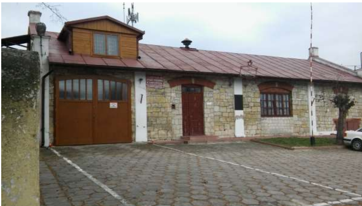
Zawichost, potrzeba kompleksowego remontu zabytkowego budynku OSP w Zawichoście z dostosowaniem do funkcji społecznych (fot. P. Pietruszka – FRESH-BIZ)
